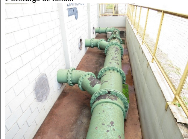
Autor: AMAE Descrição: Tubulação protegida por guarda corpo, booster Abóbora.
