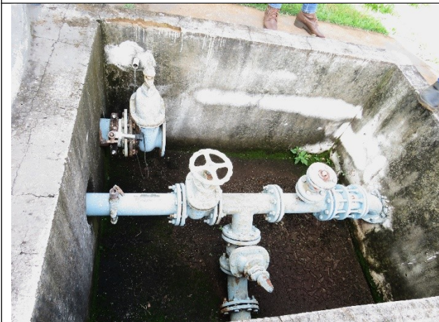
Autor: AMAE Descrição: Caixa de passagem sem tampa de proteção e descarga de fundo.
