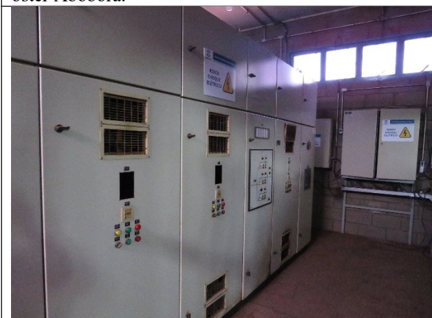
Autor: AMAE Descrição: Quadros de comando booster Abóbora.
