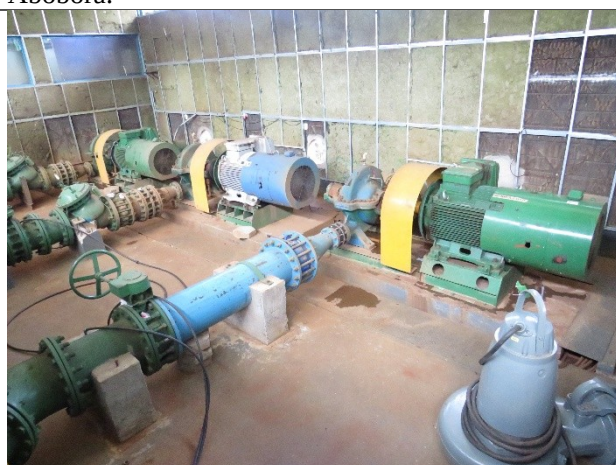
Autor: AMAE Descrição: Sistema de bombas booster Abóbora.
